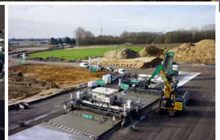
Het beton wordt 2-laags uitgevoerd om een perfect effen betonoppervlak te bekomen.
